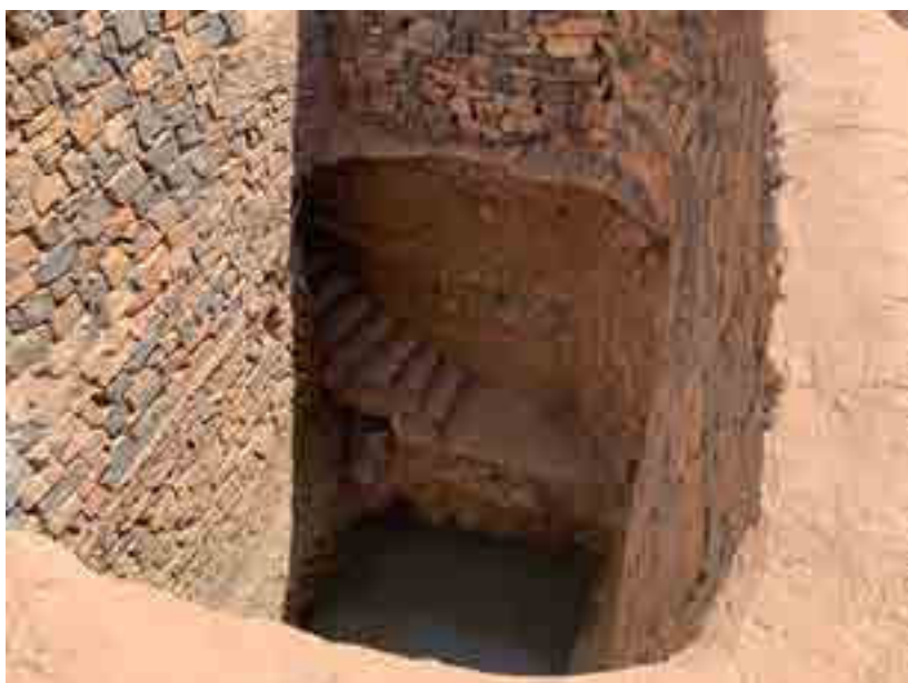
Figure 1. The lower level of water found in the Ksars, due to overheating and bad maintenance of the built environment / Le faible niveau d'eau trouvé dans les Ksars, dû à la surchauffe et au mauvais entretien de l'environnement bâti. Photo: Giulio Verdini
